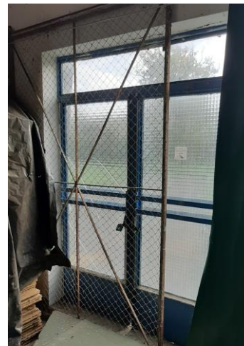
Photo grille devant porte d'issue de secours.
