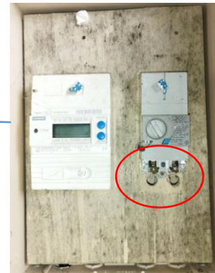
Logette tarif bleu inexploitée, ancien compteur (supposé) du centre équestre actuellement alimenté depuis le tableau général (TGBT) du club des sports
