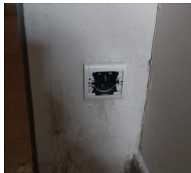
PC détériorée (ancien bureau suivant plan d'intervention)
