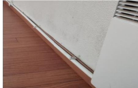
Fixations canalisation convecteur arrachées (salle de danse)
