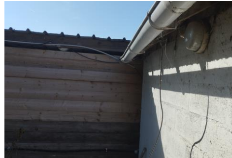
Câbles non fixés
