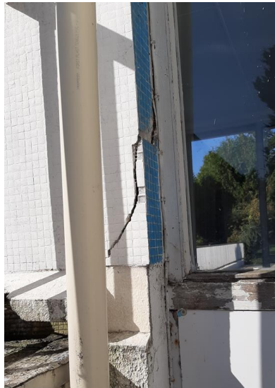
Photo fissure véranda
