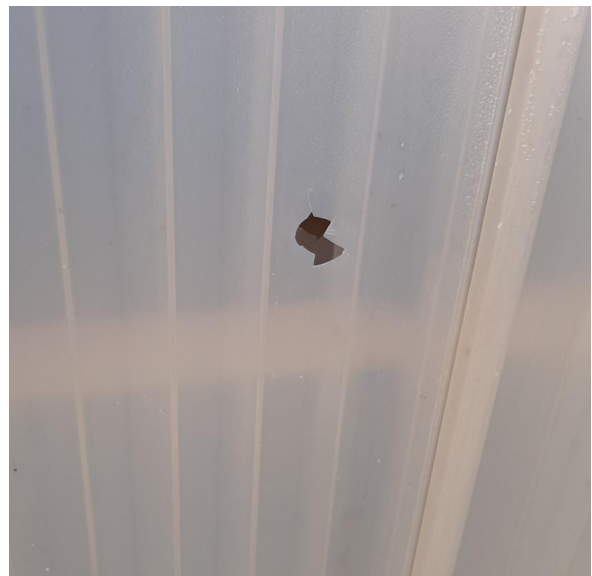
Photos bardage extérieur dégradé
