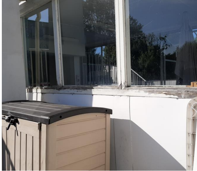
Photo bois extérieurs dégradés
